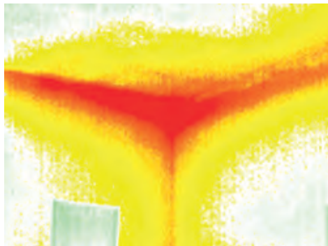
Abb. 7: Infrarotaufnahme einer vom Innenraum aufgenommenen Außenecke (geometrisch bedingte Wärmebrücke). Der rote Bereich ist durchfeuchtet und mit Schwarzsimmel belastet.
